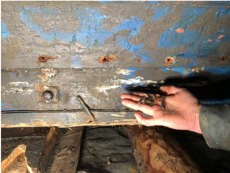
Kjølspiker, overgang mellom nederste bord og kjø, som må skiftes. Foto: Vegard
